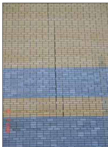
Рис. 2. Вертикальные трещины в кирпичной облицовке
