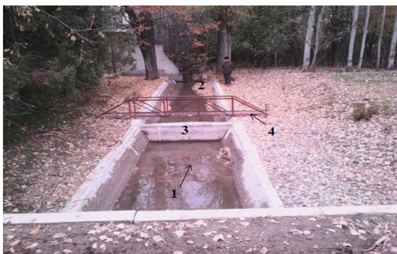
Рисунок 3 – Расходомер типа «Диафрагма» на системе ЗБЧК (здесь ранее был построен КНСБ). 1 и 2 – подводящий и отводящий каналы, 3 – диафрагма из бетона, 4 – гидрометрический мост, используемый при градуировке расходомера.
