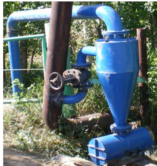
Рисунок 2 – Установка очистки воды для систем капельного орошения
