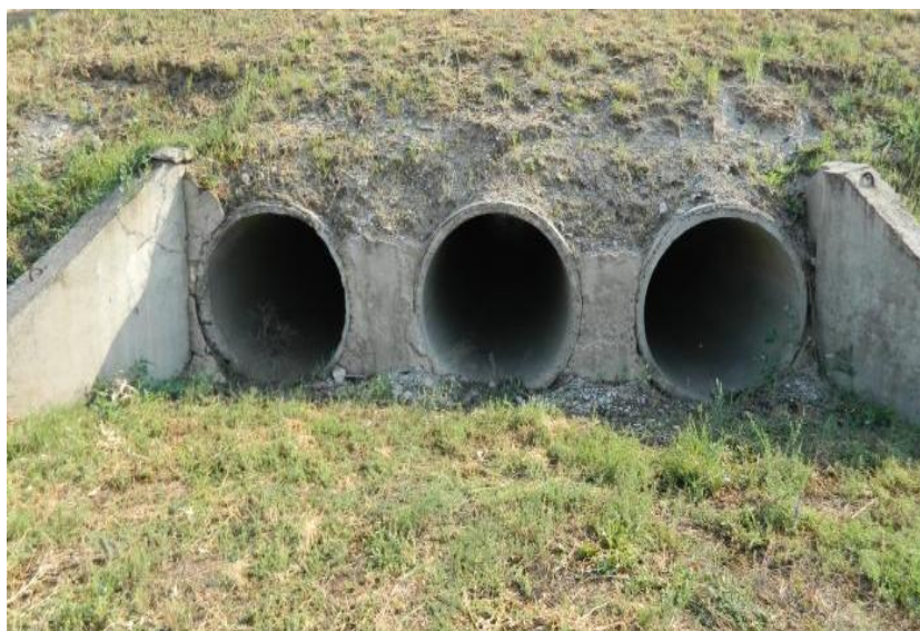
Рис. 3. Многорядное расположение водопропускных труб.
