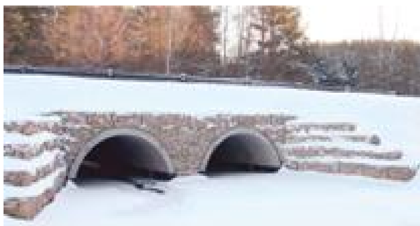
Рис. 5. Двухпролетное водопропускное сооружение с использованием сборных железобетонных арок пролетом 4 м, арочного типа на свайном фундаменте с монолитным железобетонным ростверком.
