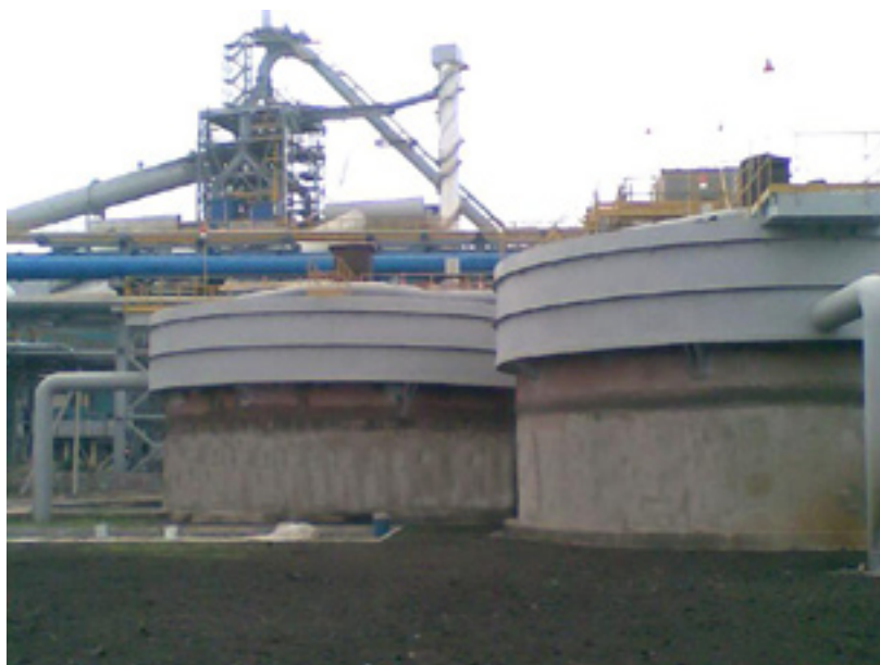
Рис. 1. Установка водоподготовки оборотного цикла газоочистки доменной печи № 7 ОАО «Новолипецкий металлургический комбинат».
