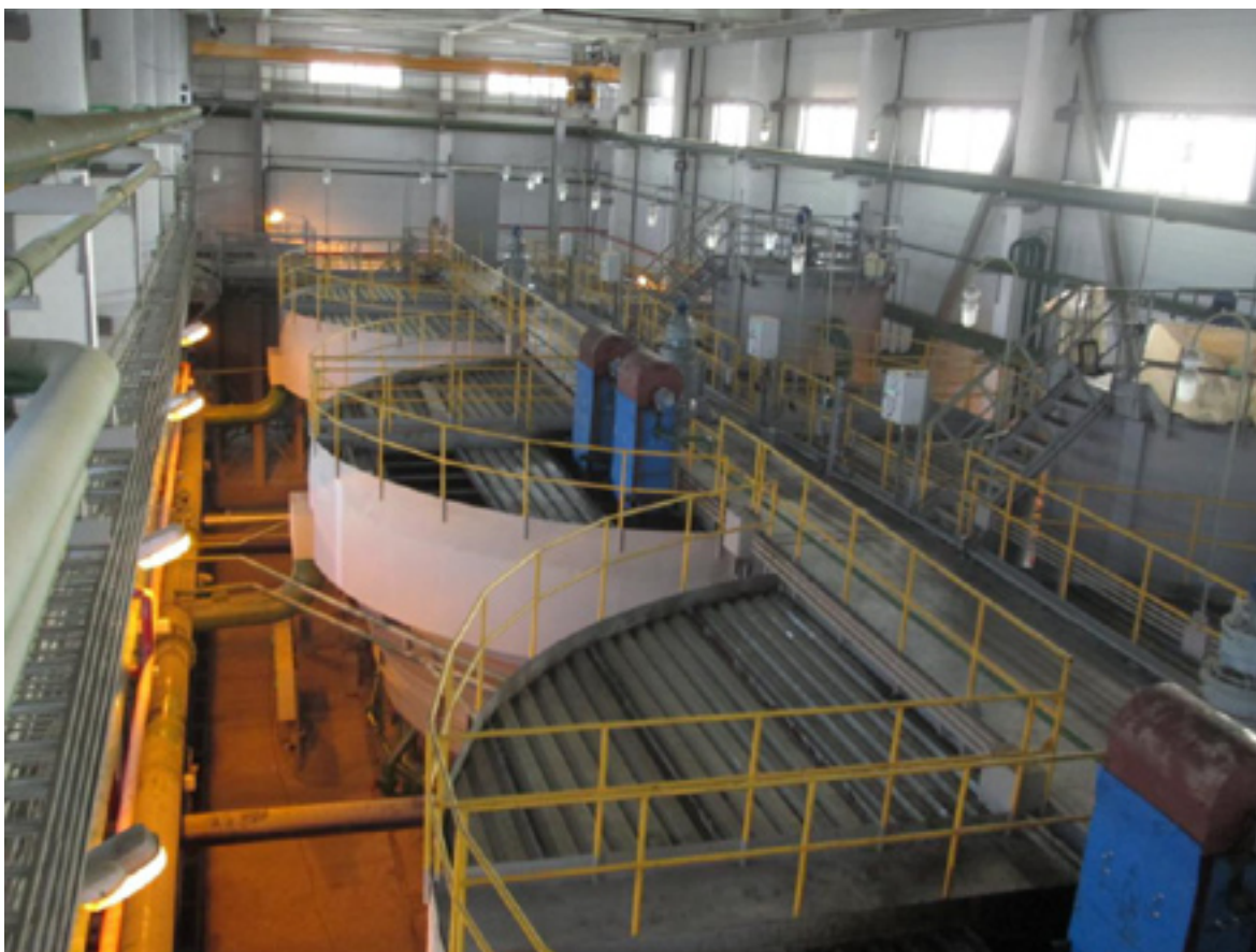
Рис. 2. Отстойники-флокуляторы внецеховых очистных сооружений оборотного цикла группы трубопрокатных цехов Первоуральского новотрубного завода.
