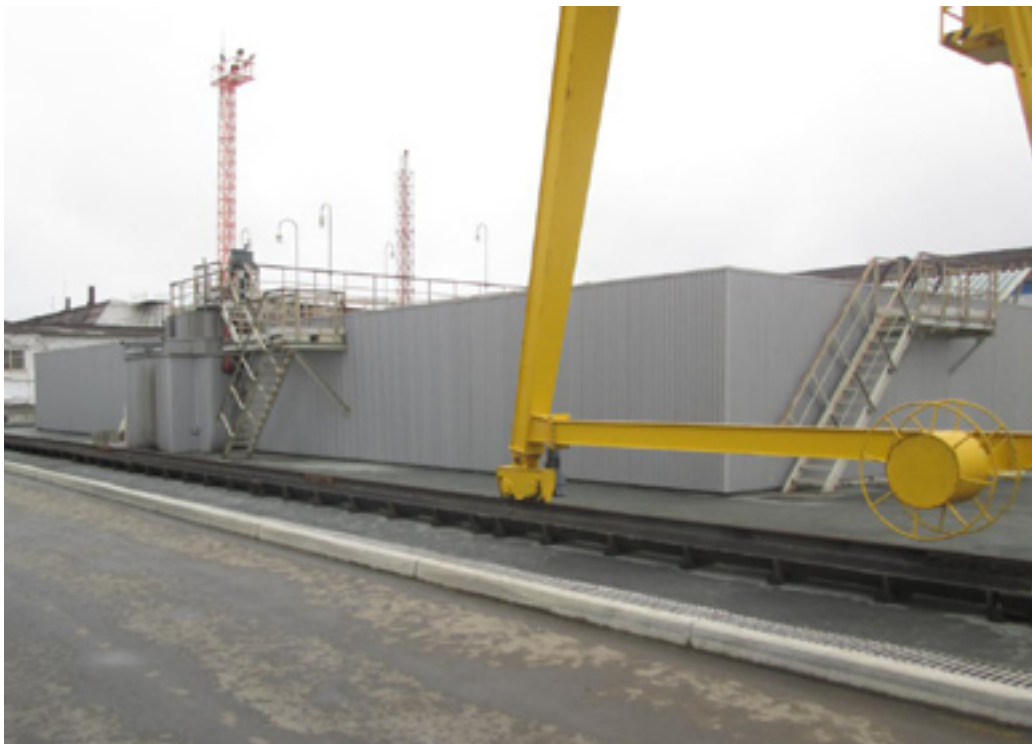
Рис. 3. Секции ОКУД внецеховых очистных сооружений оборотного цикла группы трубопрокатных цехов Первоуральского новотрубного завода.
