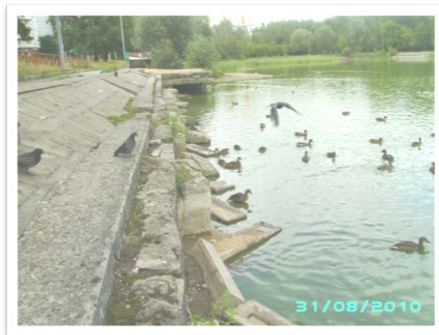
Рис. 1. Состояние берегоукрепления пруда на Ярославском шоссе
