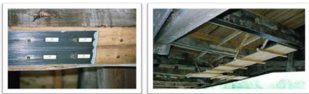
Рис. 2. Усиление опорных балок моста с помощью углеродного волокна в преднапряженном состоянии в г. Син (Швейцария)
