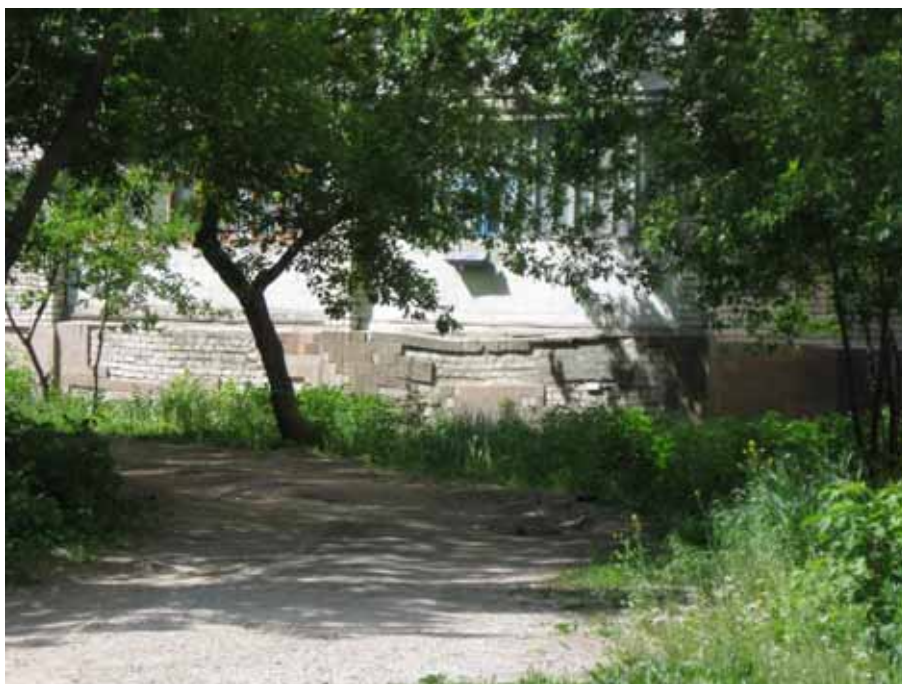
Рис. 1. Деформации основания здания в результате периодически повторяющихся просадок (Прибрежный мк-рн г. Дзержинска)
