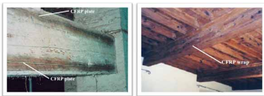
Рис. 3. Углепластиковые включения в несущие деревянные конструкции
