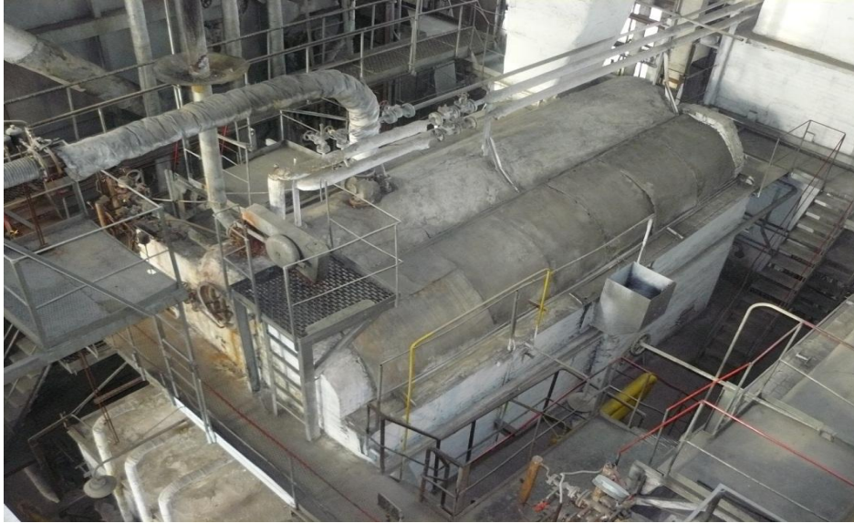
Рис. 5. Фрагмент ТЭЦ (котел ДКВР-15/13)
