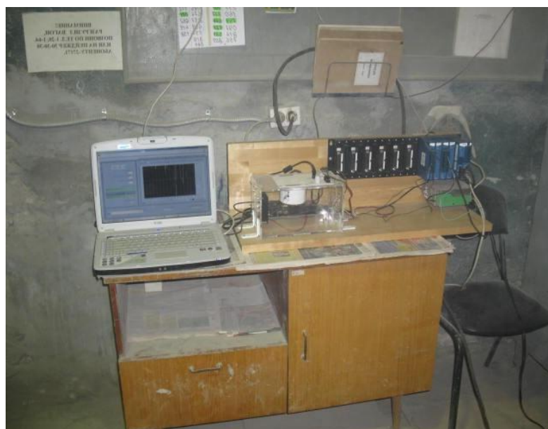
Рис. 3. Пункт управления, система визуализации
